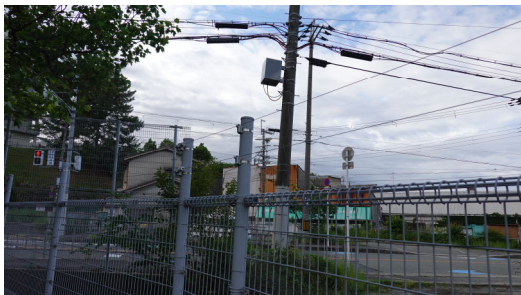
フェンスセンサー
