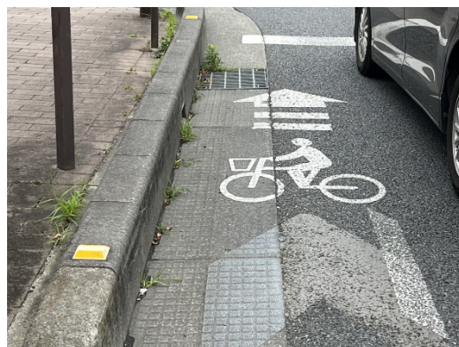
車道と側溝の接続部分に段差のある箇所
