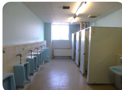
福祉施設のトイレ。照明だけでは薄暗い印象を受ける。
