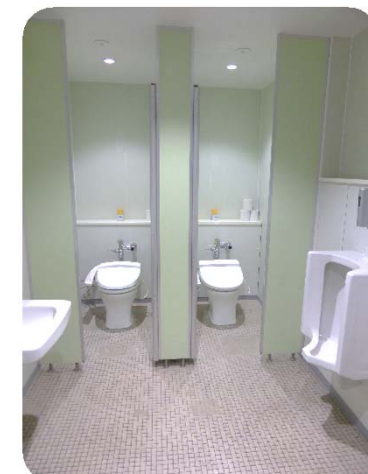
市役所庁舎のトイレ。LED照明により、十分な明るさを確保している。人感式のため、効率も良い。
