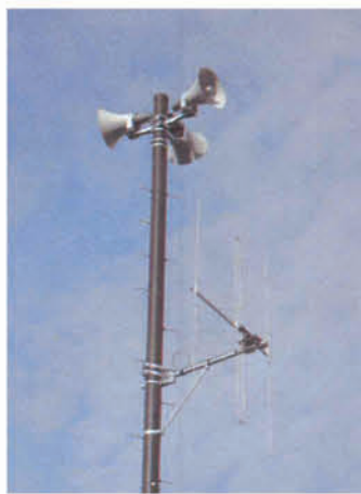
向田児童遊園地に設置された防災行政無線
