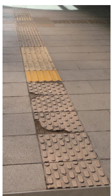
破損がひどく、形状もバラバラな点字ブロック
