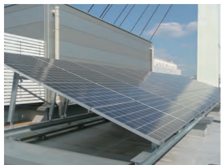
▶学校給食センターの太陽光発電パネル
