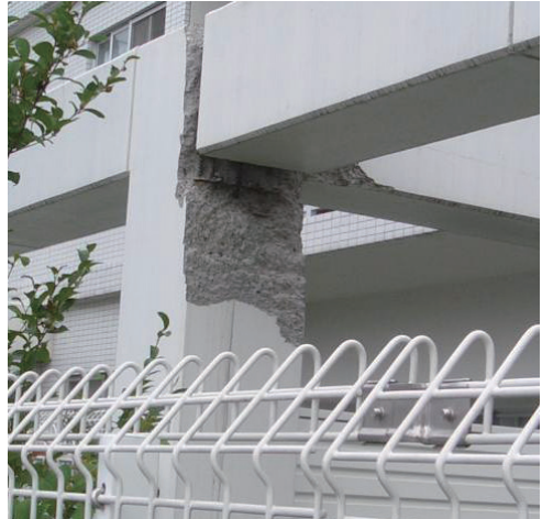
▲地震で壊れたマンションのはり
