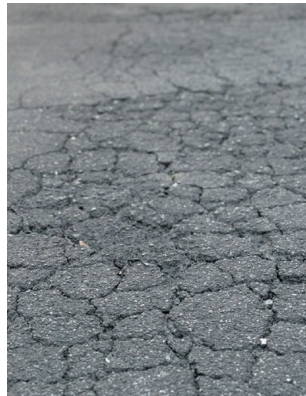
劣化した道路
