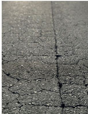
補修待ちの道路
