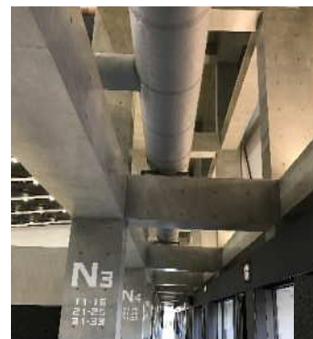
配管がむき出しとなっているが、あえて天井をなくしたことで、上からの落下物がない。
