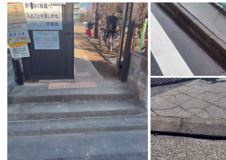
市内には至るところに段差が見られます
