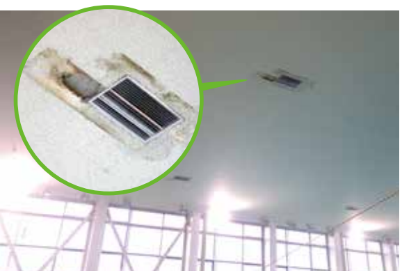
▶戸田市スポーツセンターの天井落下部分
