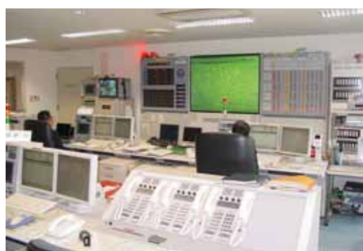
▶消防本部通信指令室
