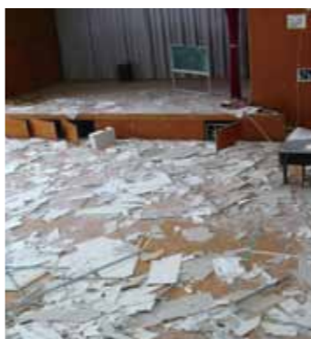
▲天井の部材が大量に落下した学校体育館 ※東日本大震災・長野県栄村（提供：財団法人消防科学総合センター）
