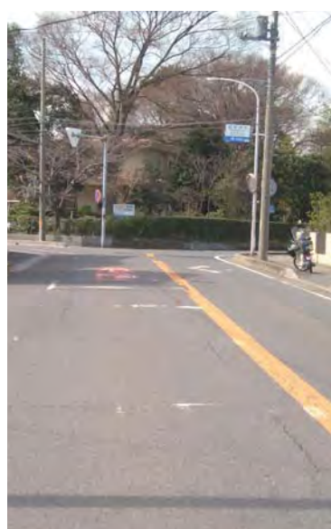
▲路面標示が消えている新曽小通り
