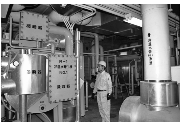
▲市庁舎の冷暖房をまかなう空調機械室
