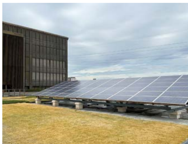
市庁舎4階の屋上庭園に設置してある太陽光パネル
