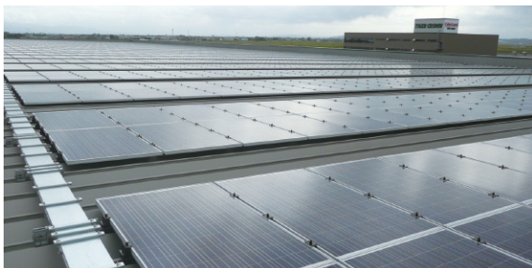
▲マッチングにより事業所に設置された太陽光パネル
