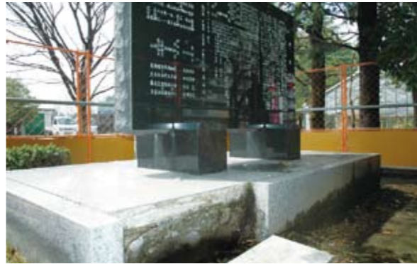
土台が崩れた北部公園内の石碑
